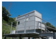
非常用発電設備
