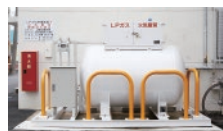
災害用LPガス貯槽
